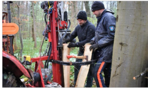
Le chantier bois au parcours de santé est celui qui a rassemblé le plus de participants. Photo DNA/T.P.
